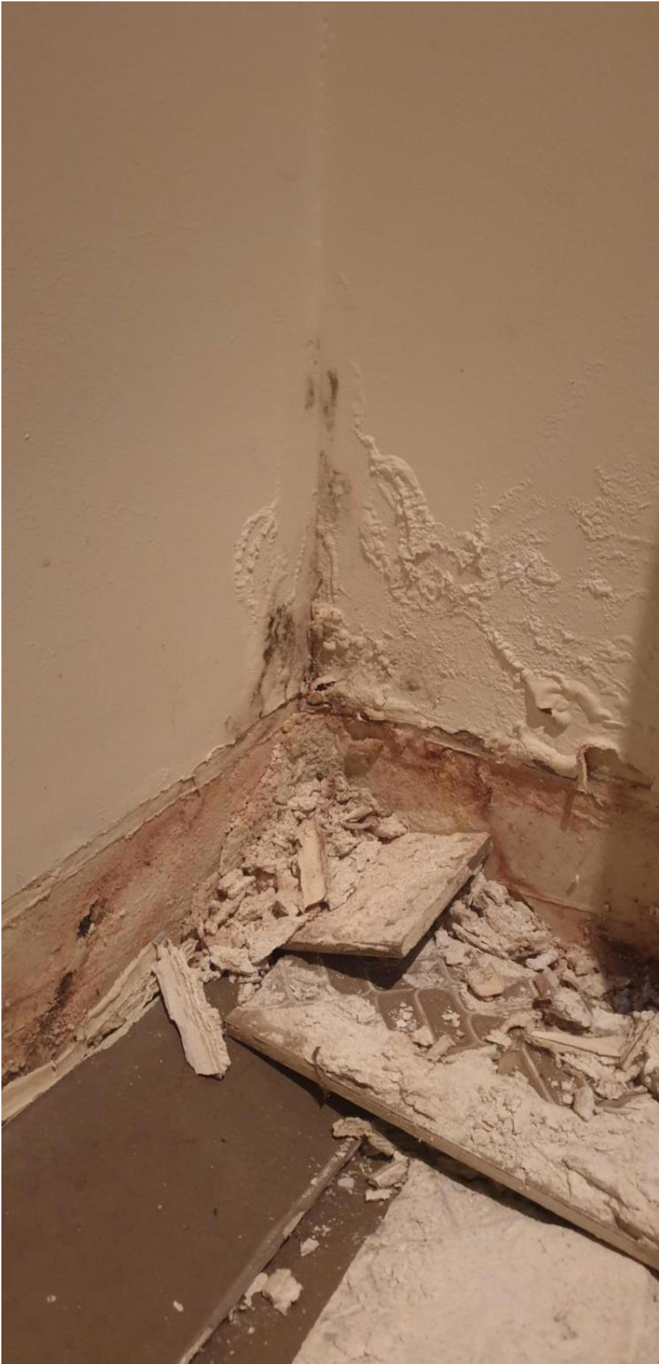
Le logement est déclaré insalubre. - D.R.
