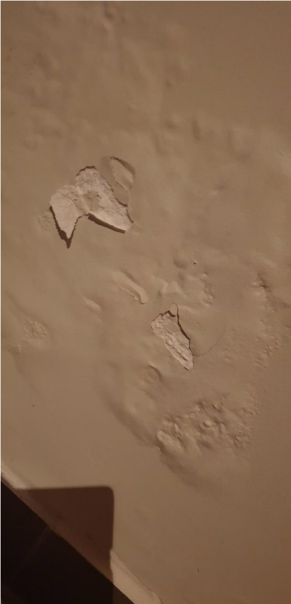
L'humidité suinte des murs. - D.R.
